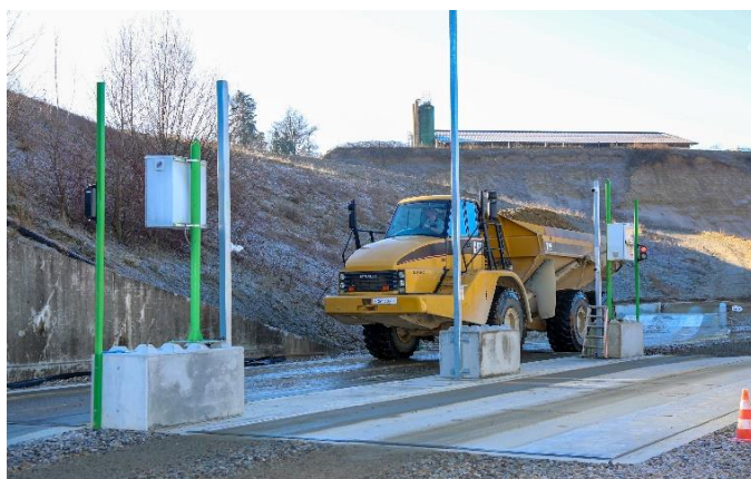
Die Waage mit vollautomatischer Ein- und Ausfahrtskontrolle reduziert Wartezeiten für die Chauffeure.
